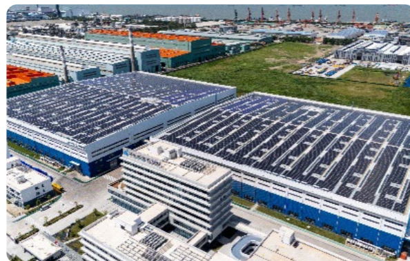
苏州工厂光伏项目
